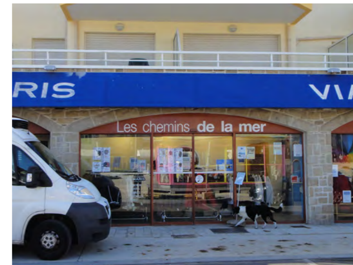
Inclinaison trop importante Linéaire continu devant plusieurs baies Écriture sur le store
